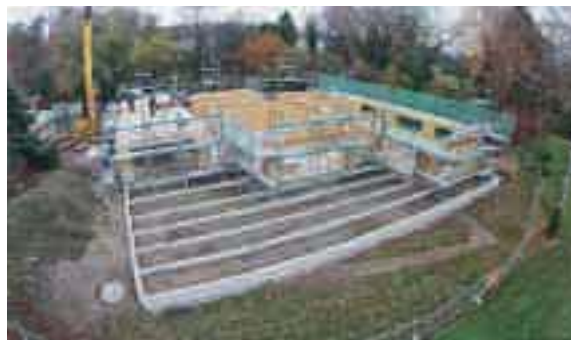
November 2014: Das Fundament ist gelegt, die Wände für das neue Haus stehen.
