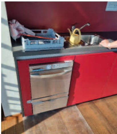
Die Spülmaschine im Hafenmeisterhaus musste getauscht werden.
